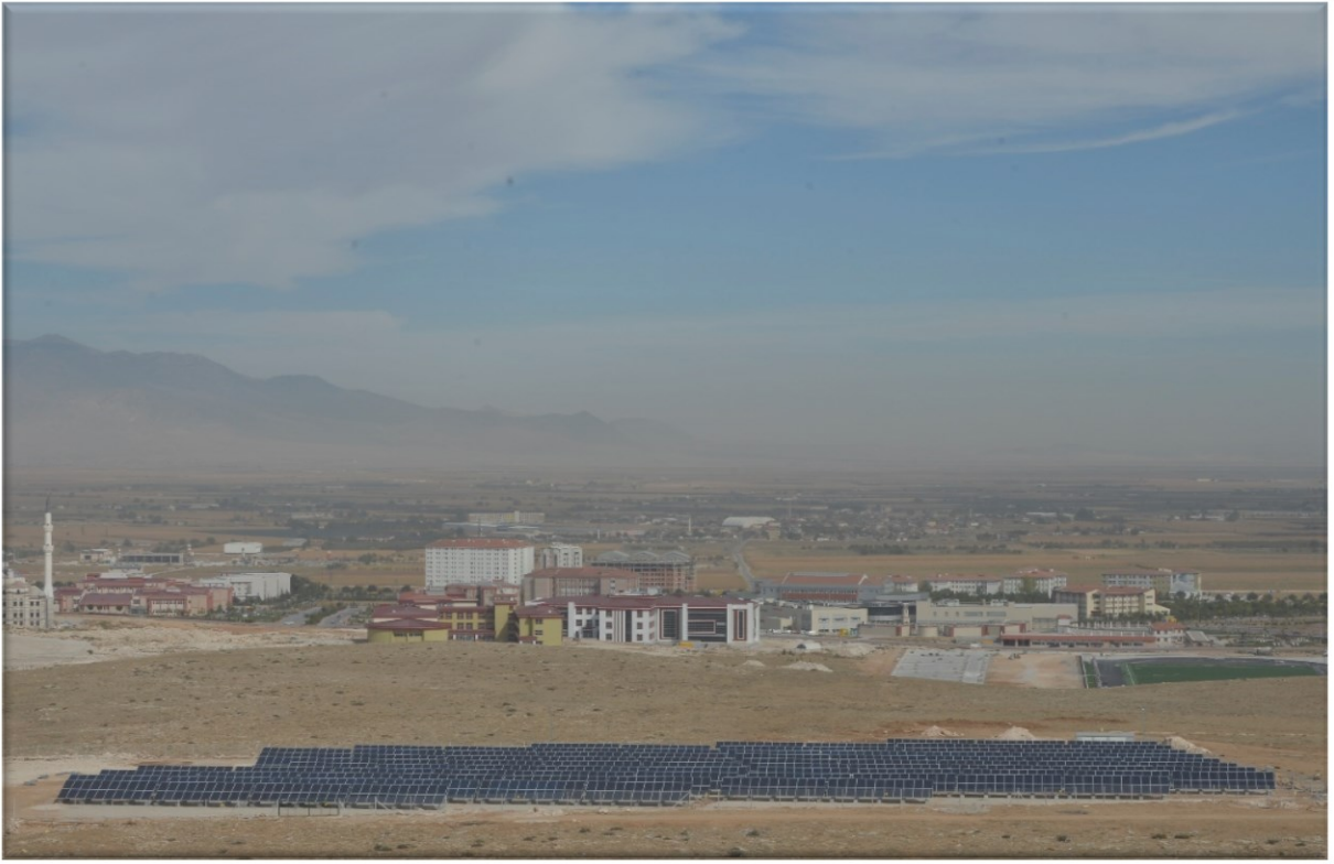
Şekil 12: Güneş Enerji Santrali
