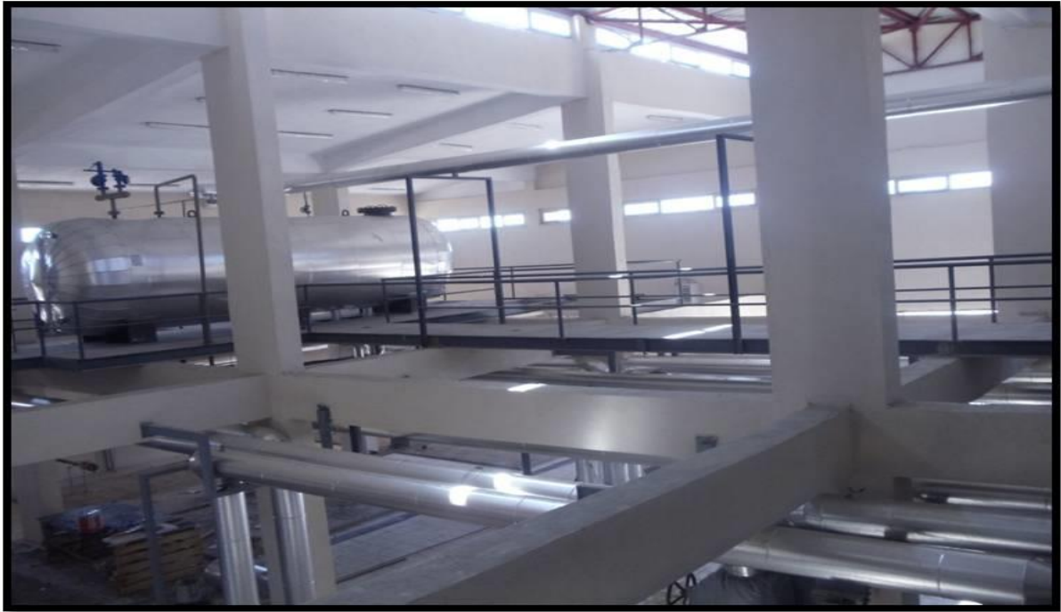
Şekil 9: Isı Merkezi İç Görünüm
