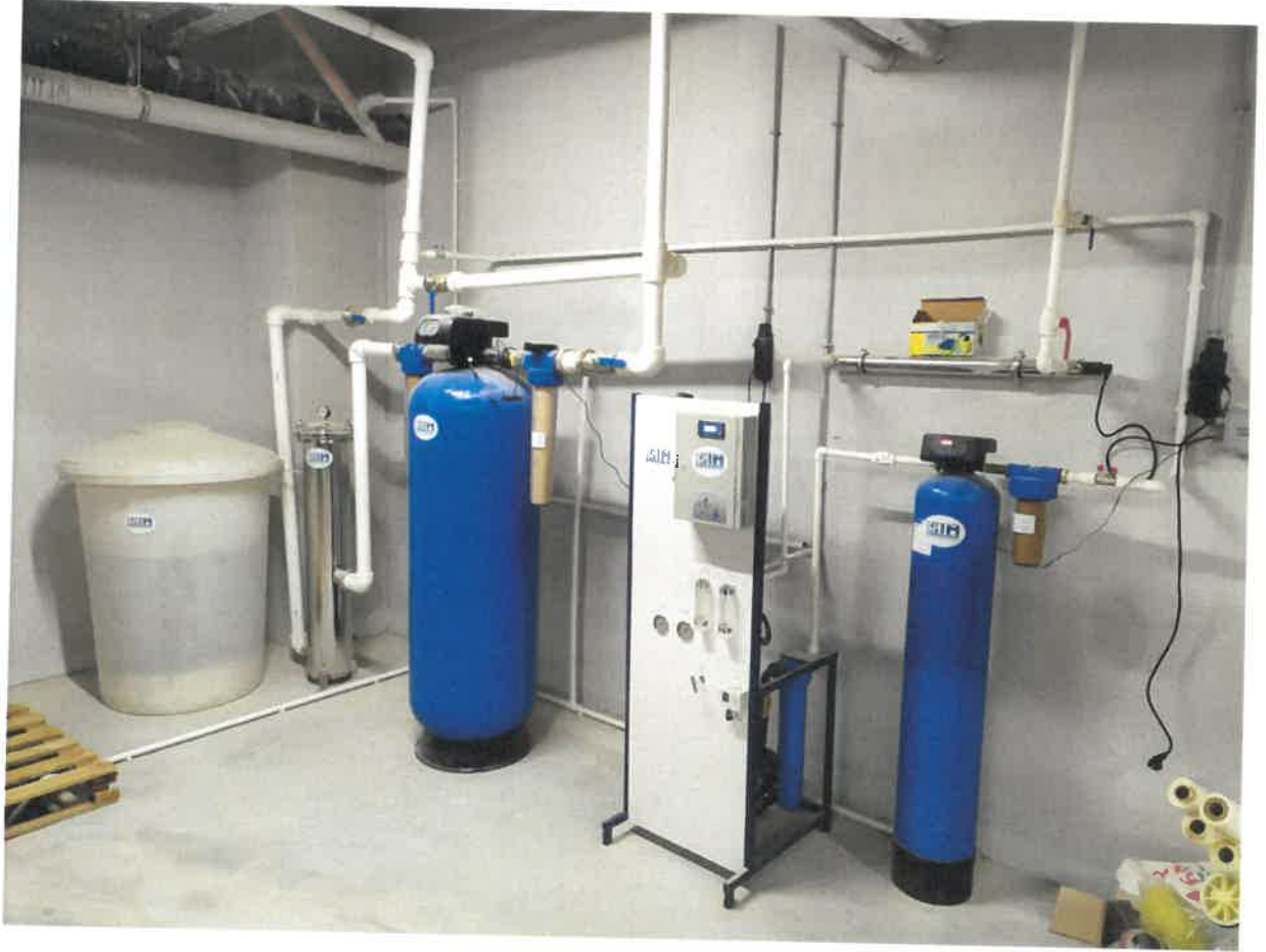
Ters Ozmos Sistemi (Bina Su Arıtma Sistemi)
